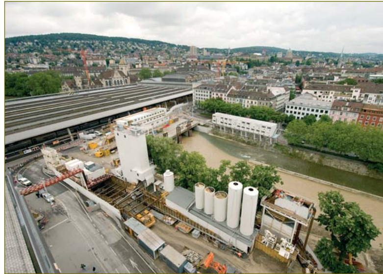
La nouvelle gare «Löwenstrasse» se développe, traversée par la «Sihl» sous la gare principale de Zurich.
